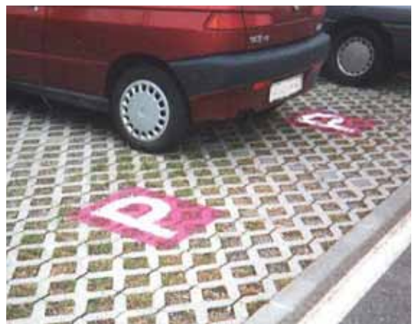
Segnaletica orizzontale non conforme a legge
