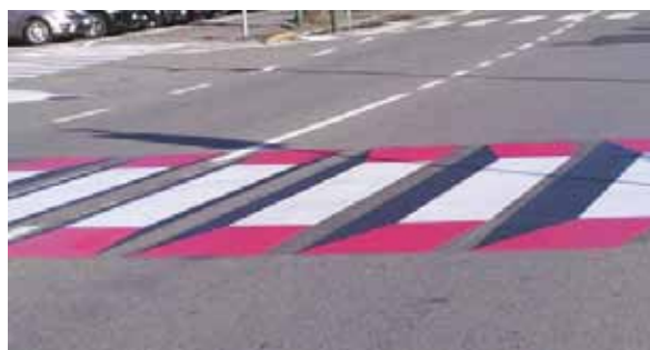
Strisce pedonali realizzate su fondo stradale con colorazione non conforme a legge
