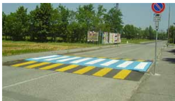
Attraversamento pedonale rialzato non conforme a legge
